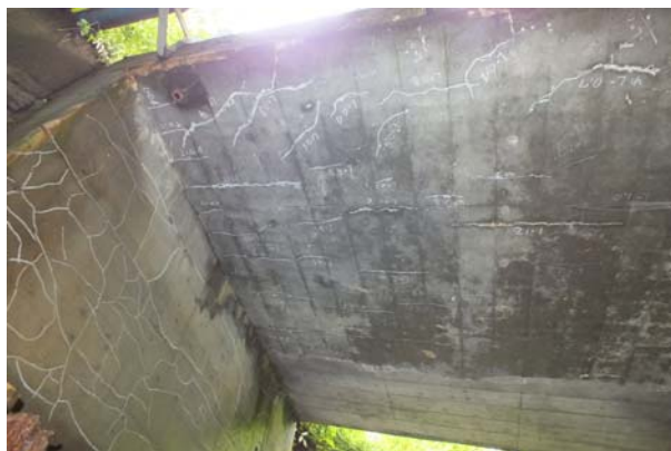
健全度 III : 底水線 1 号橋
